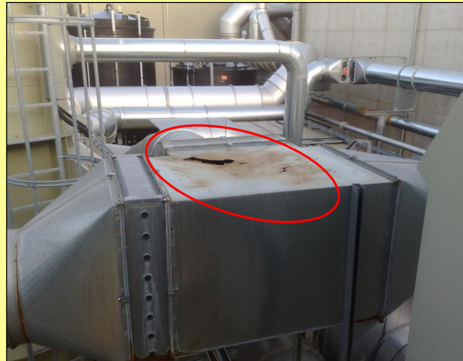
Rohgasleitung zur RTO
